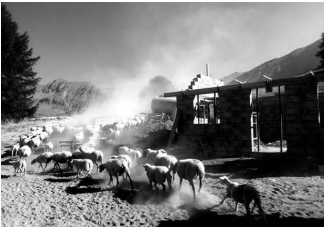
Ces dernières années, des rénovations de cabanes voient le jour, mais il y a trop d'aberrations quant à leur emplacement, leur conception et leur fonctionnalité. Elles sont rarement pensées pour faciliter le quotidien et le travail, quand bien même le coût de leur réalisation est subventionné et pèse peu sur les employeurs.
